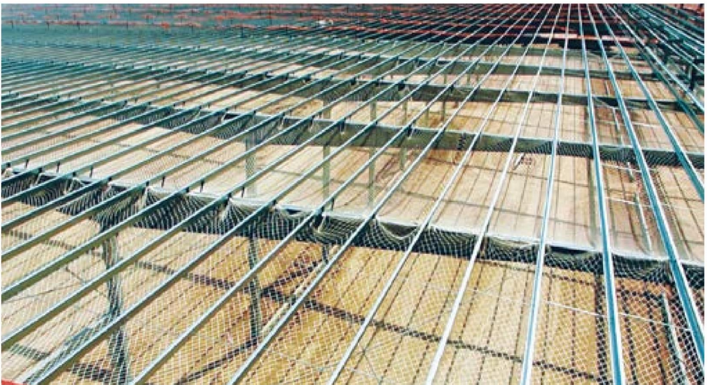
Lưới bảo vệ an toàn trong quá trình lắp dựng công trình.
